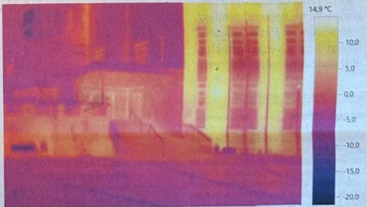
Die Wärmebildkamera zeigt, wo die größten Schwachstellen am Gebäude sind. Foto: privat
